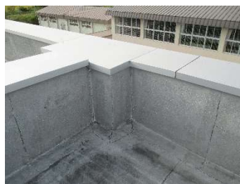
屋上防水層の膨れ (由仁中学校)
