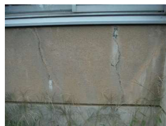
外壁仕上モルタルの亀裂 (由仁小学校)
