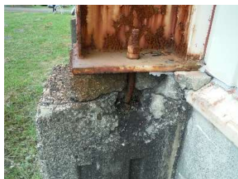
モルタルの剥落・アンカーボルト の露出 (由仁町体育館)
