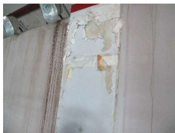
塗装の剥離 (町民プール)
