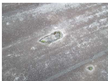
屋上防水層の破断 (町民プール)
