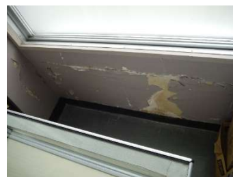
塗装の剥離及びボードの損傷 (ゆめつく館)
