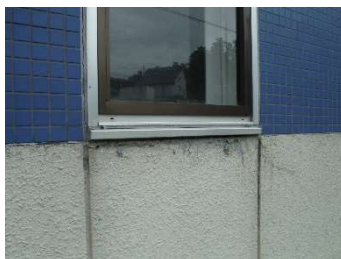
サッシシーリングの劣化 (由仁農村勤労福祉センター)
