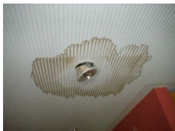
雨漏り (町民プール)
